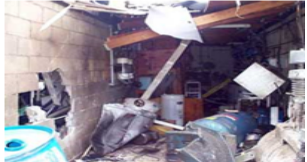
Explosión de Compresor de Aire
