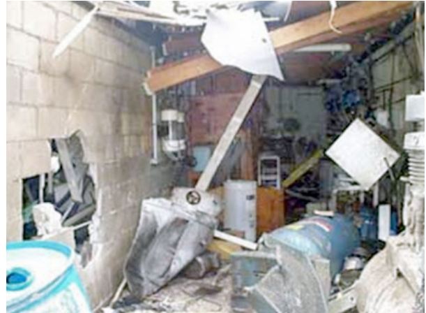
Explosión de un Compresor de Aire
