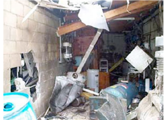
Explosión de Compresor de Aire 1
